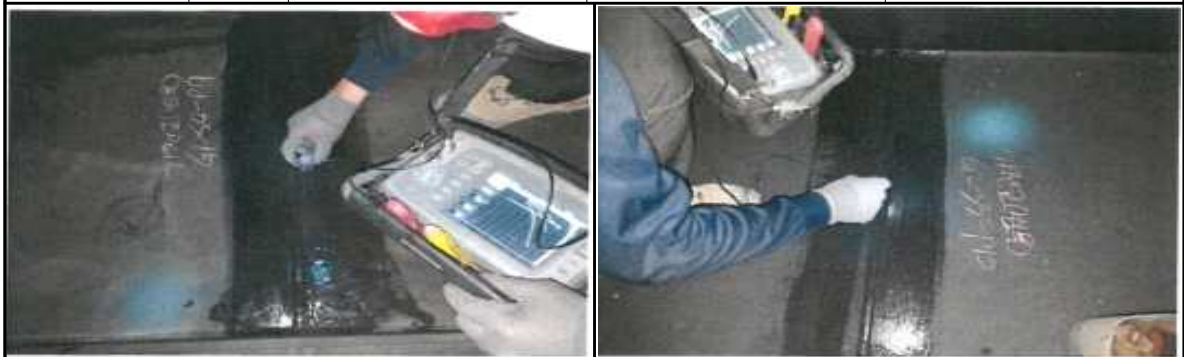
<사진 3.3.1> 맞대기용접부 결함조사(UT)
